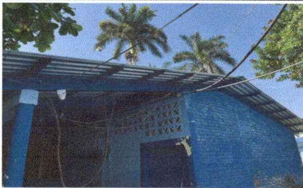
Foto 3: Sustrucción de lámina acanalada, por lámina troquelada aluzinc calibre 26, en módulo de baños.
